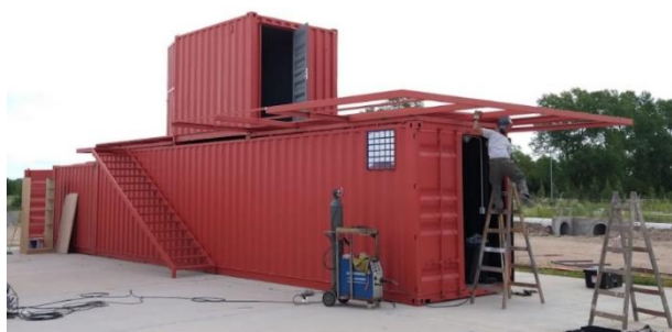
Fig. 2. Vista del módulo completo instalado
