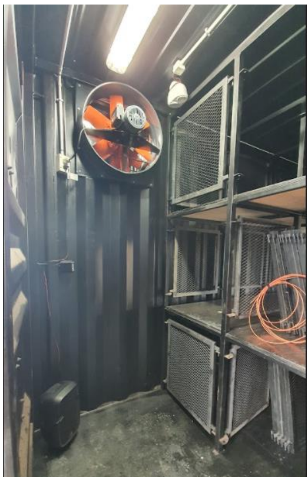
Fig. 4. Vista del extractor industrial instalado
