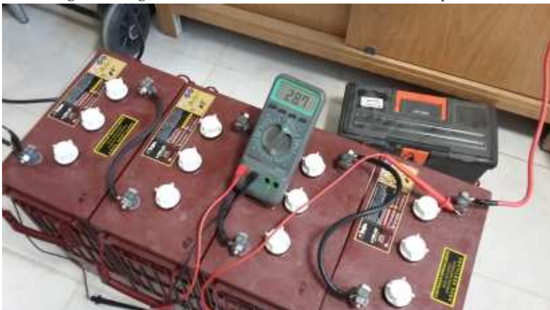
Figura 6: Nuevo banco de baterías de 24 V / 390 Ah en ensayo con tablero reconstruido
