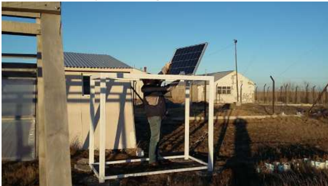
Figura 8: Ubicación aproximada del juego de paneles fotovoltaicos sobre soporte elevado, en preparación
