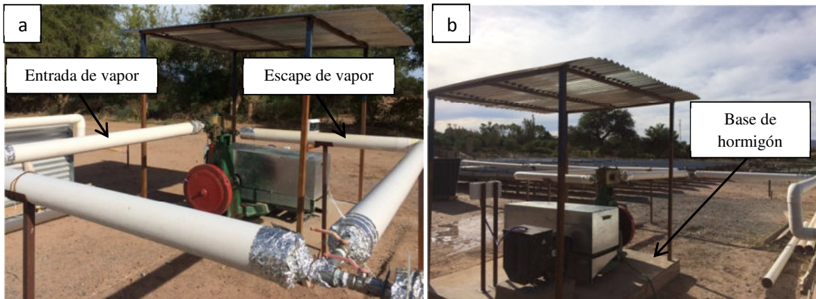
Figura 13: a) Vista de conexiones a línea de vapor. b) Vista de acoplamiento eléctrico y tablero.
