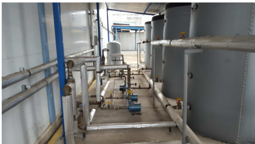
Figura 7: Sistema de Armazenamento.
