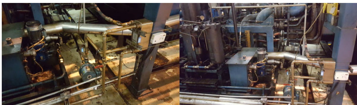
Figura 8: Sistema de trocador de calor de 5.000 litros.
