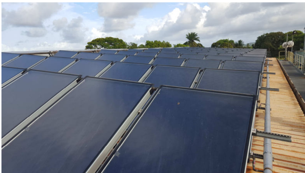
Figura 6: Sistema de coletores completo, formado por 140 coletores térmicos.
