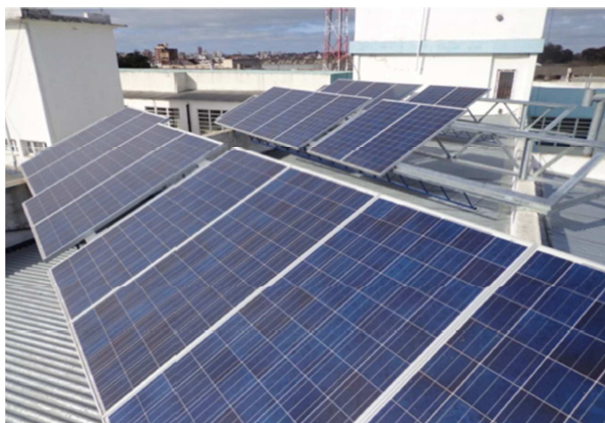
Figura 3: Planta piloto FV en la terraza del edificio FI-UNMDP (inclinación de panel 30°)
