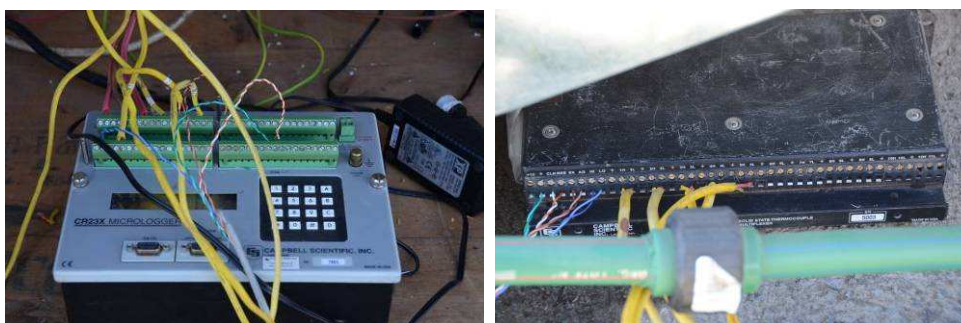
Figuras 8 y 9 – Instrumental: Datalogger y multiplexor utilizados. Se aprecia conexiones de termocuplas.
