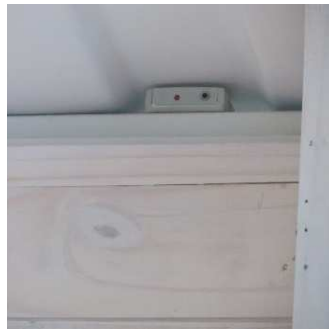
Figura 11. Detalle, sensor alto, dormitorio 1
