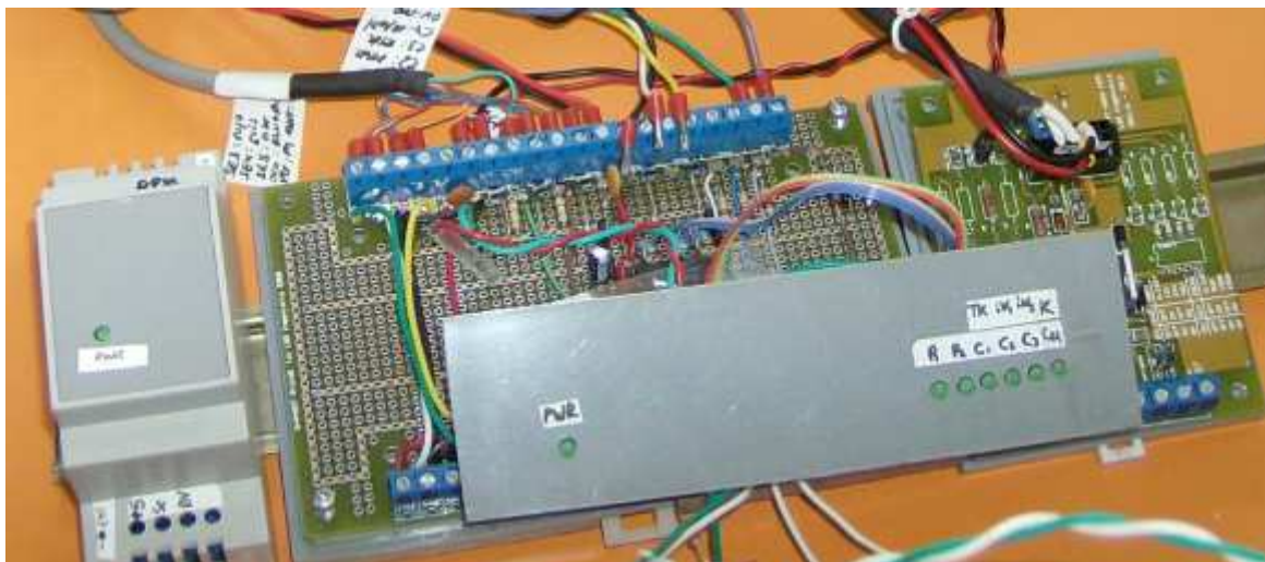
Figura 10 (izq) Modulo F2V, (centro) Acondicionamiento señales R840, (der) placa VIN-IAE
