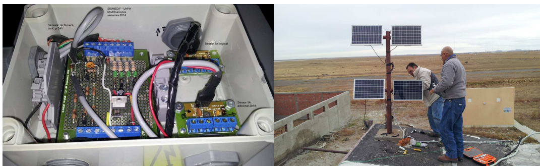
Figura 3: Modificación sistema de sensores para 2 canales I (ACS014-5), uno de V (2014) (izq), y montaje de paneles inferiores, canal IFV2 (der.)
