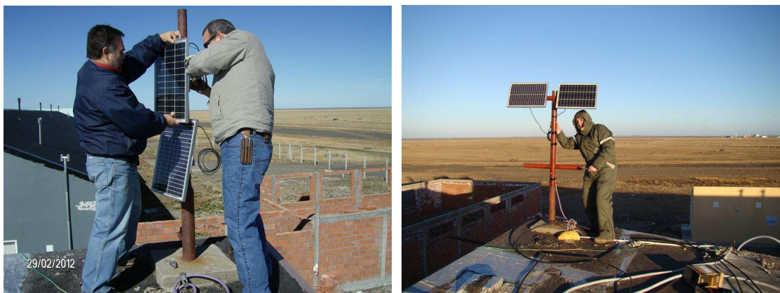
Figura 1: Montaje de paneles en techo Lab. AEA (izq) – Reinstalación con nuevo soporte (der)
