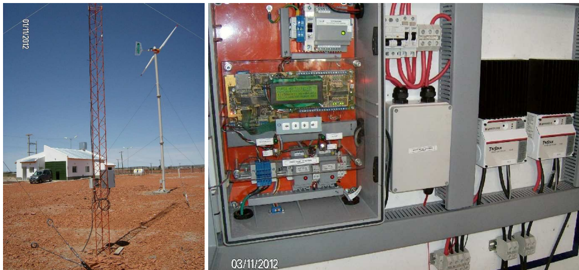
Figura 3 Equipamiento en Campo de Pruebas INTI - Cutral Có - Máquina INVAP IVS4500, torre de METEO/Nomad2, PWRC2/48V con sensor de 150A y dos reguladores TS60
