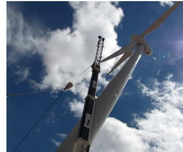
Figura 8 - Torre metálica 85m Impsa IWP-83. La Rioja, Argentina.
