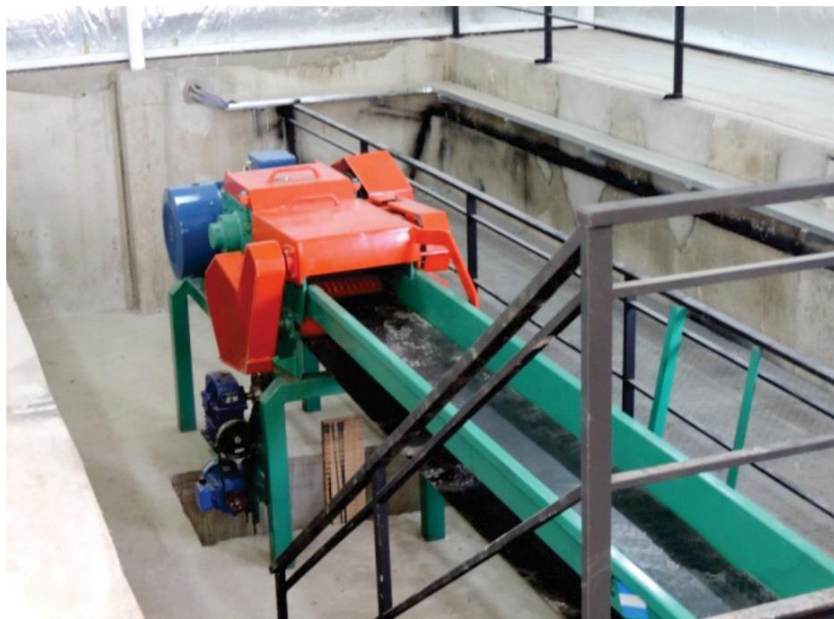
Figura 3.34. Cinta transportadora de productos secundarios y astilladora puesta en servicio-CTM. Fuente: propia (2019).
