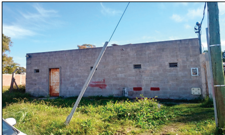
Figura 1. Edificación en donde se encuentra el tablero eléctrico desde el cual se acciona el funcionamiento de la planta. Autoría: Miembros del equipo del Vector Integración de Barrios Populares, Facultad de Ingeniería, UBA
