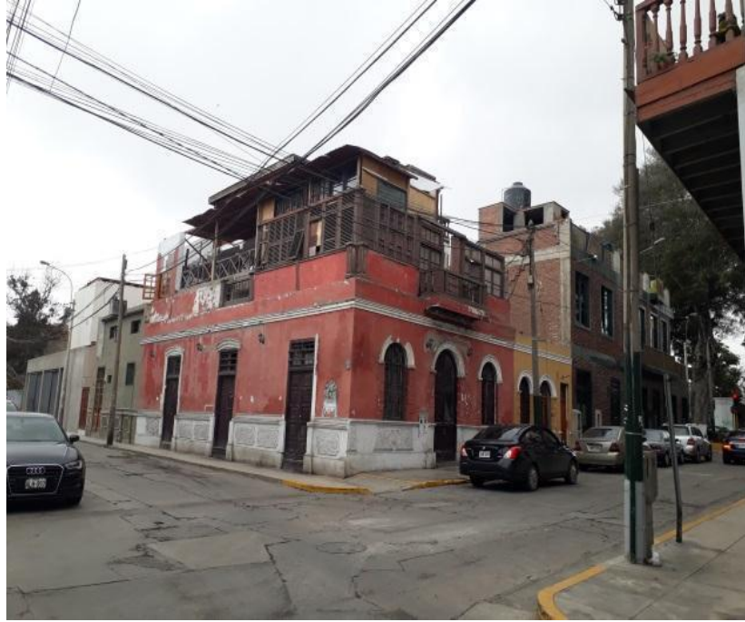
Imagen 3: Casa deteriorada Barranco
