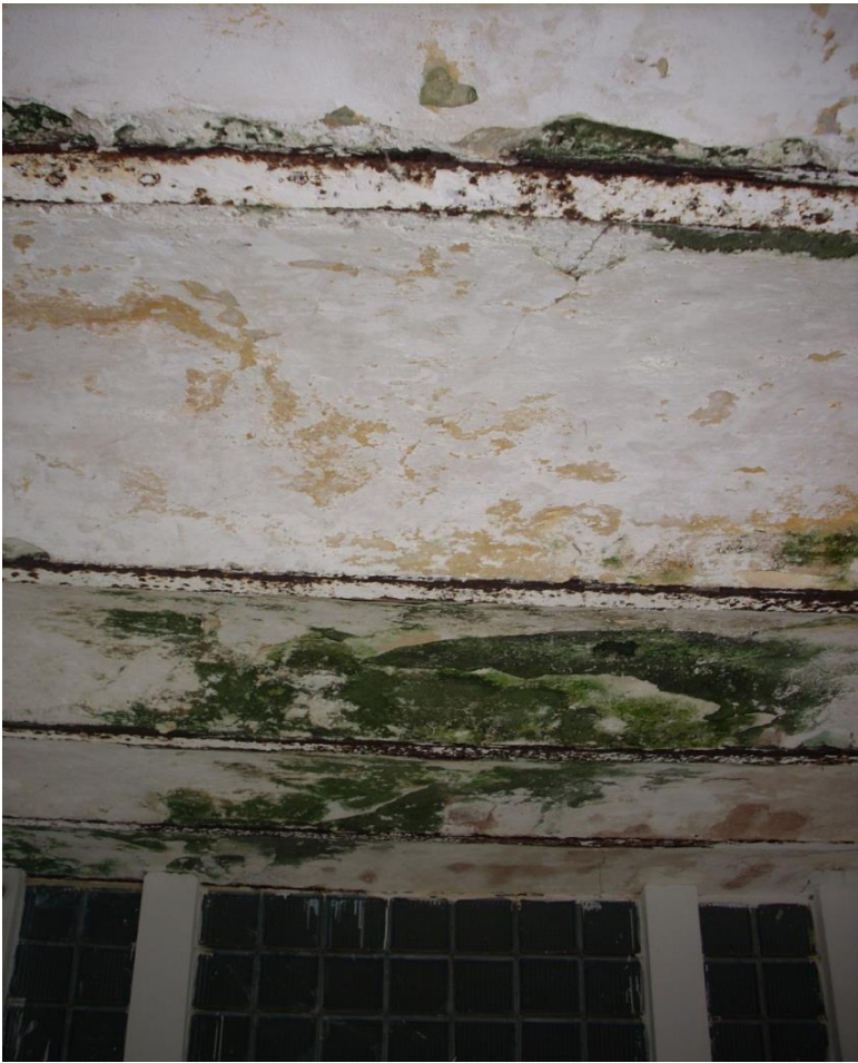
PARTENON – ESTADO PREVIO A LA RECUPERACION (PATOLOGÍAS)
