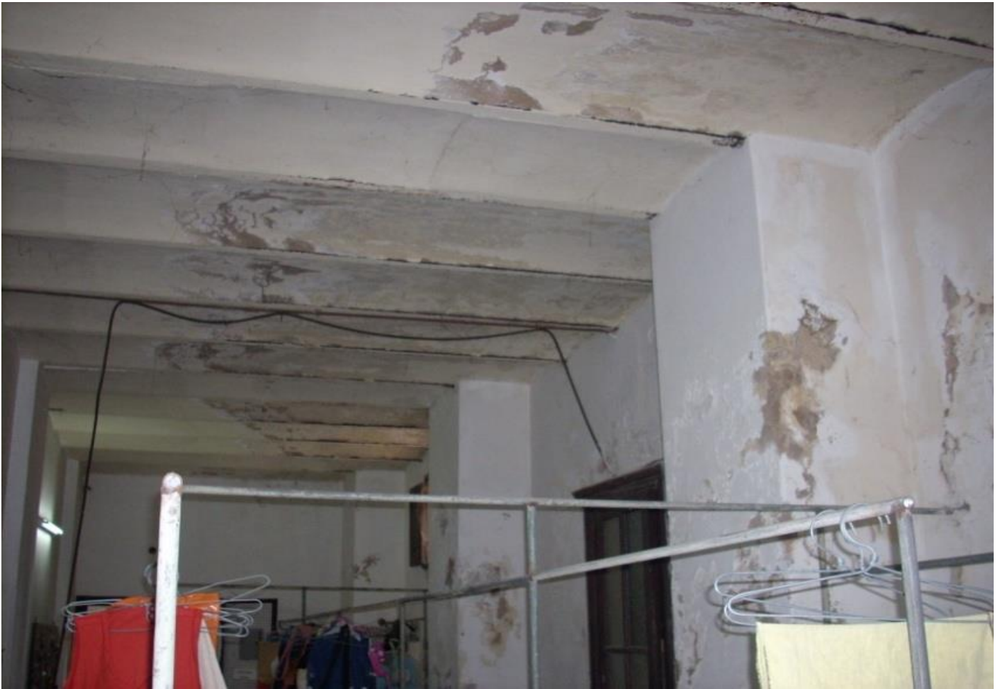
PARTENON – ESTADO PREVIO A LA RECUPERACION (CIELORRASO SUBSUELO)
