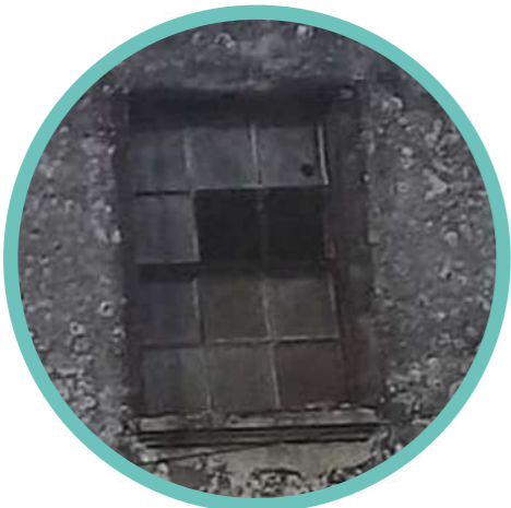
Carpinterías totalmente en abandonos
