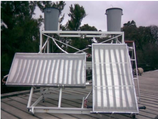
Fig. 6. Calefones solares en escala real, con cañerías de polietileno de 2” en disposición horizontal o vertical según los requerimientos de instalación en el terreno.
