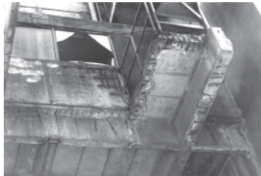
FIGURA 3: Deterioro del hormigón visto de pasillo de circulación a nivel del piso 14°. Conjunto Urbano Soldati. 2002. Fuente: PMH, FADU, UBA.
