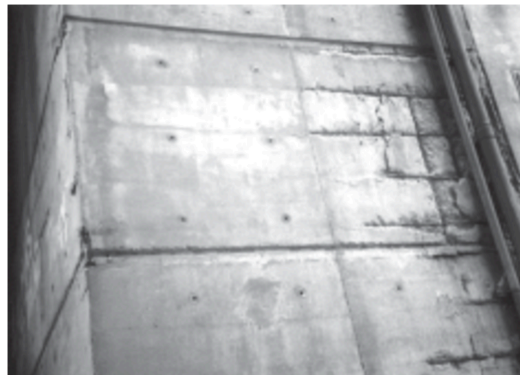
FIGURA 4: Deterioro del hormigón visto del tabique portante, a nivel del 3° piso del nudo circulatorio de 15 pisos. Conjunto Urbano Soldati. 2002. Fuente: PMH, FADU, UBA.
