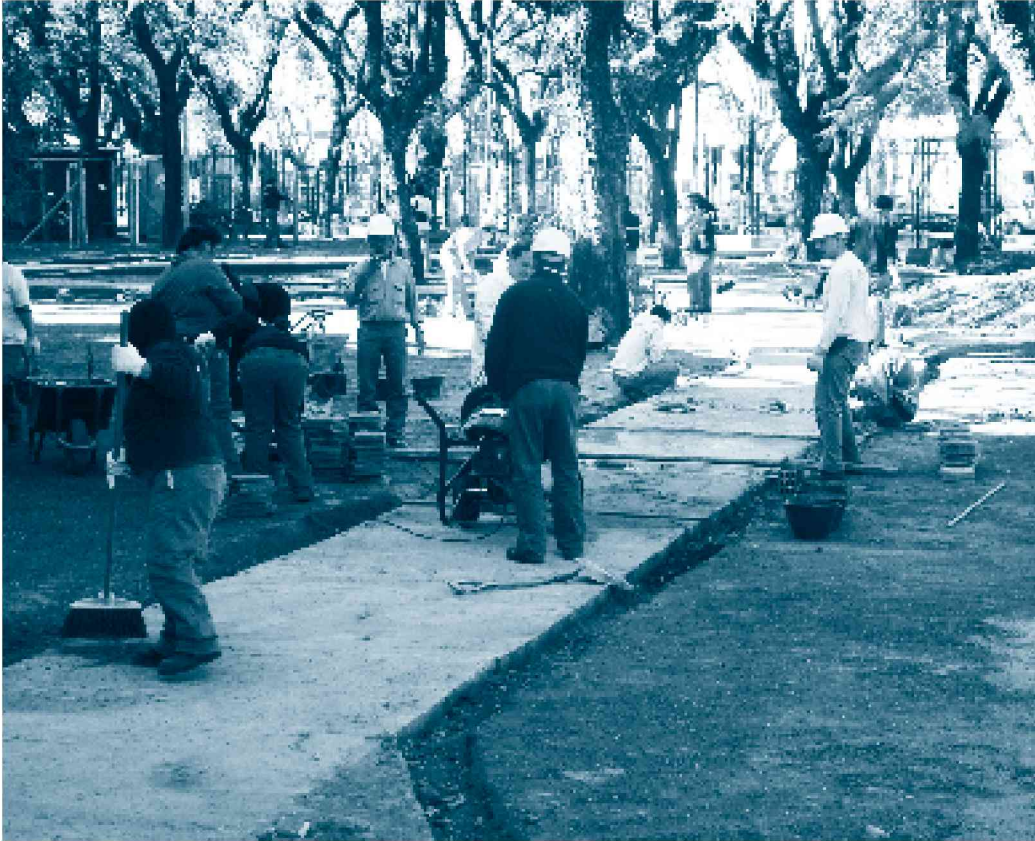
Los trabajos incluyen la construcción de veredas en los alrededores de la Facultad
