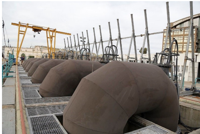
Figura 6.30: Descarga al Riachuelo de la Estación de Bombeo número 2, con 8 bombas, en La Boca-Barracas, CABA
