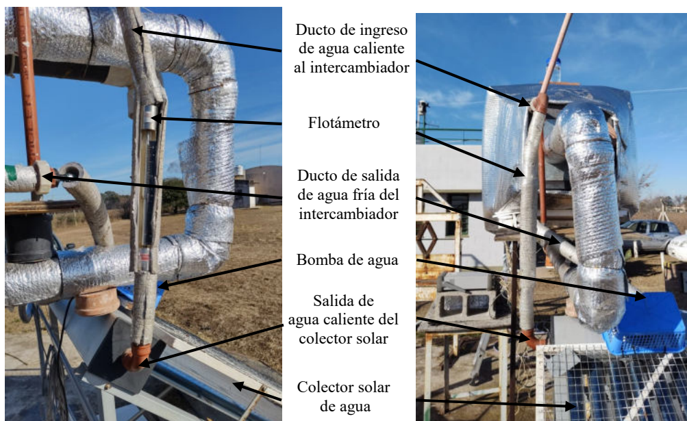
Figura 2. Vista parcial del circuito del agua. Flotámetro, bomba de agua y colector solar.
