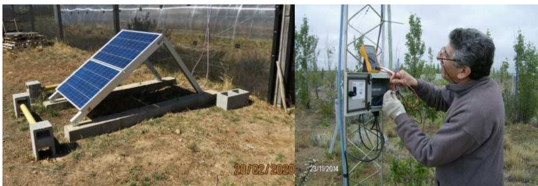
Figura 4: (izq) Banco de paneles solares (200 Wp) agregado en 2017 y control del módulo METEO externo en instalación inicial del sistema de medición.
