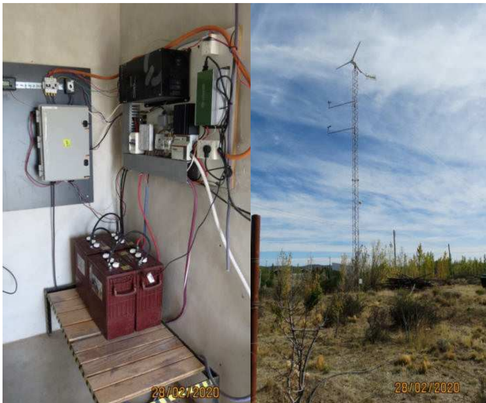
Figura 3: (izq) Nuevo banco de baterías, regulador y cargador, (der) control del funcionamiento de aerogenerador y sensores ambientales en 2020.
