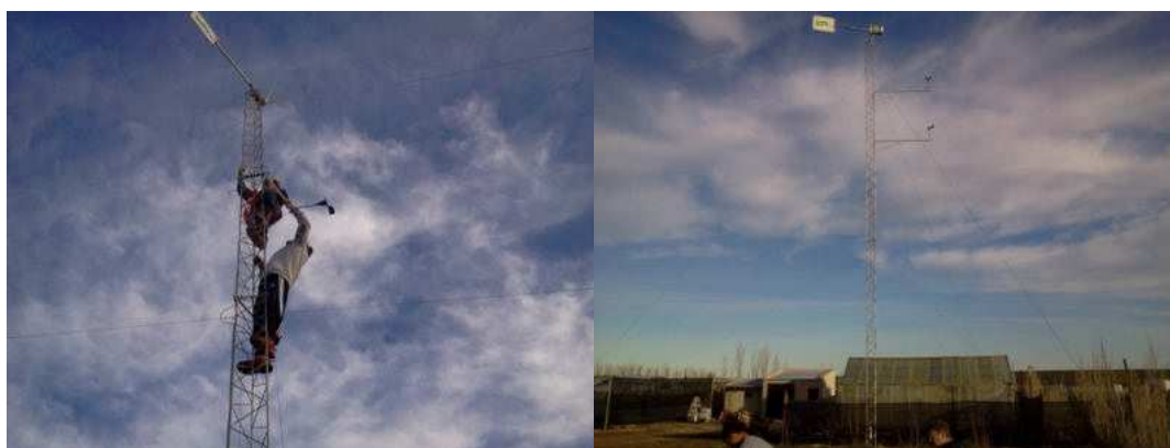
Figura 1: Instalación del boom con sensores de viento instalados e invernadero UNPA de fondo
