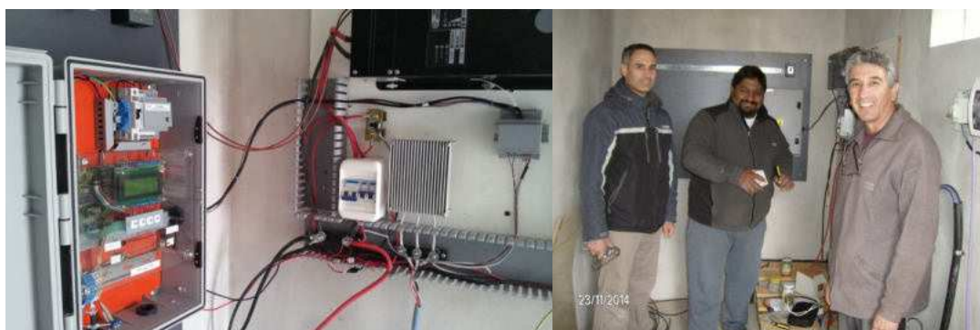
Figura 2: SISMED/SJ24 y tablero instalados 11-2014 con sensores, Inversor QMax y rectificador
