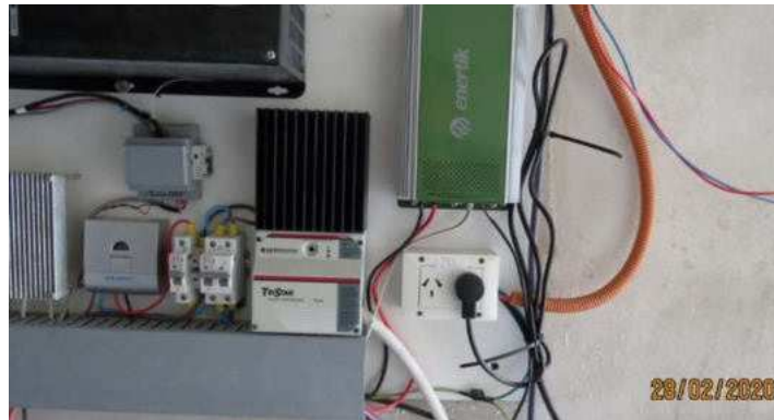
Figura 5: Detalle del regulador solar Solartec, módulo de medición VIN_IAE, regulador Tristar TS60 (en configuración desvío de carga) y cargador de emergencia EnerTik 15A.
