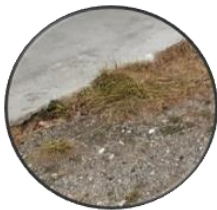
Suelo afectado por la obra
