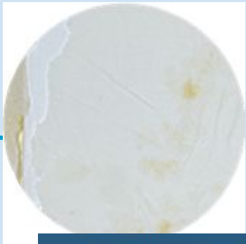
Doblecres y desprendimientos
