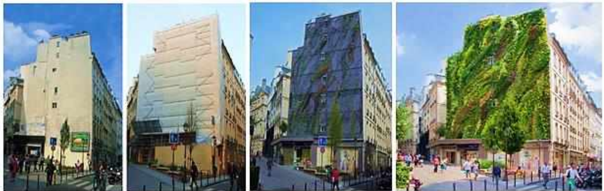
Figura 83 Instalaci n del SJV hidrop nico L'Oasis D 'Aboukir (Paris). Autor: Patrick Blanc (2013)
