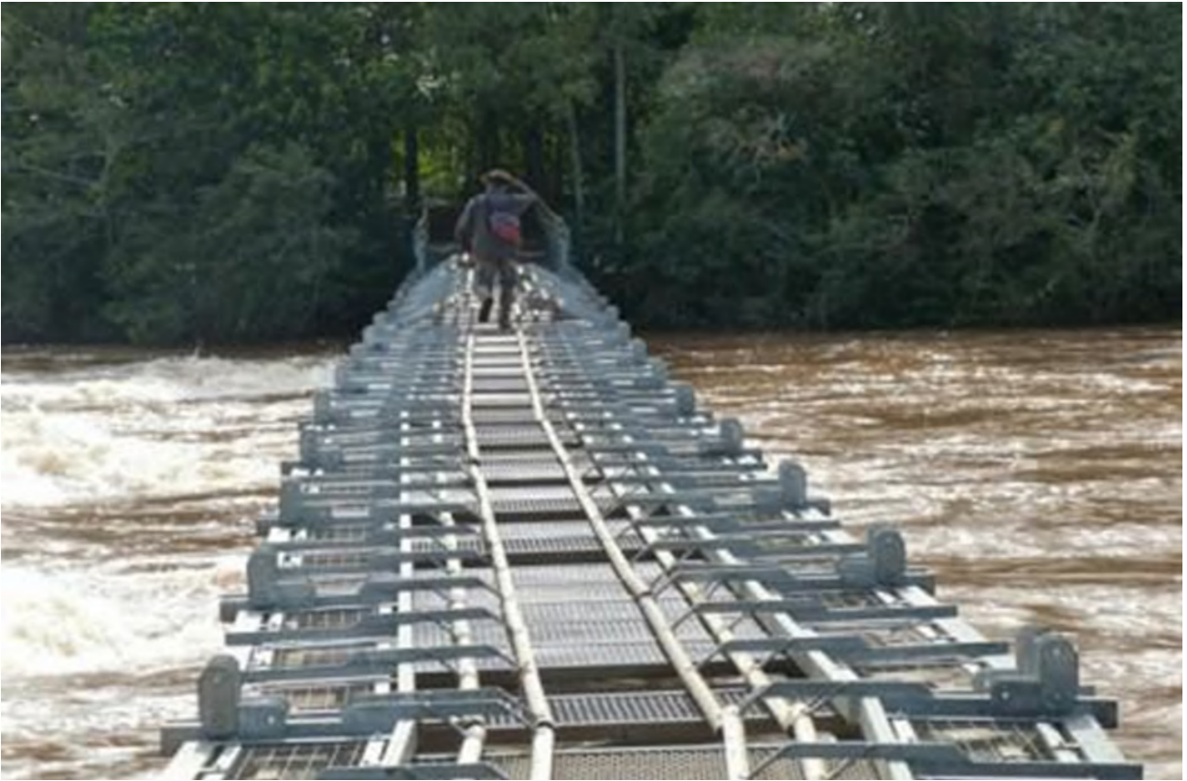
Tramos con barandas completamente rebatidas
