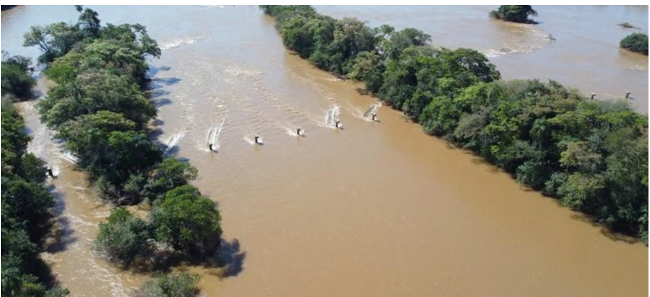
Tramos de pasarela que permanecieron amarrados a las pilas luego de su caída
