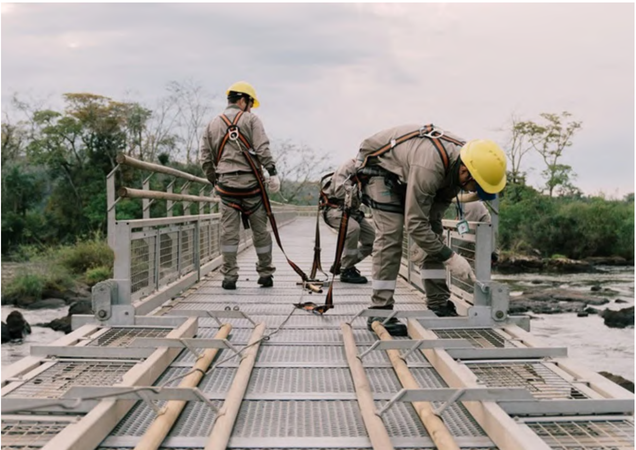
Operación de rebatimiento de barandas ante alerta de crecida, se requiere solamente quitar un bulón en cada extremo del tramo.
