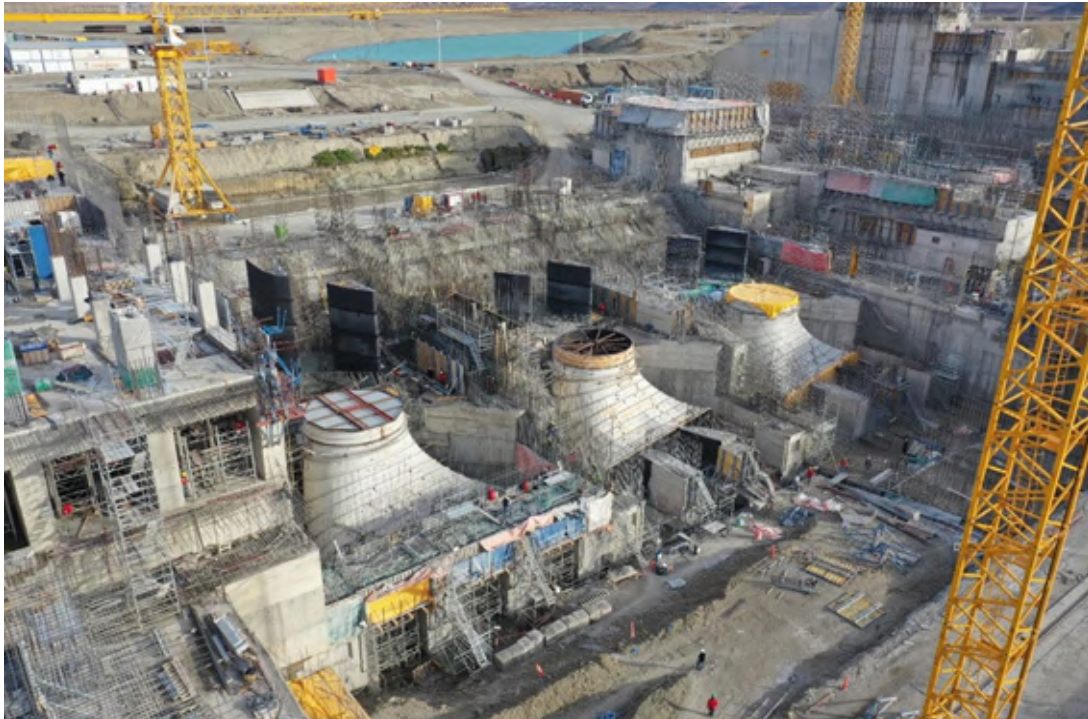
Figura 12.- Vista de los tubos de aspiración de las tres turbinas del aprovechamiento JC
