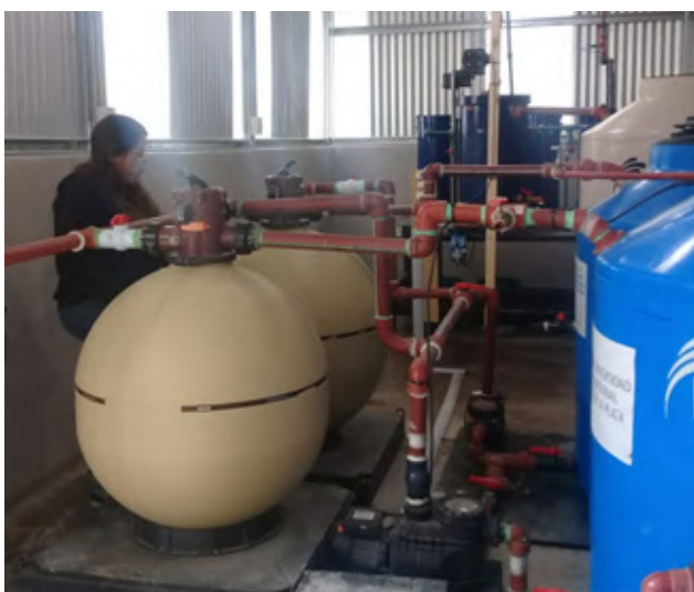
Fig.5 – Planta instalada en Pipinas
