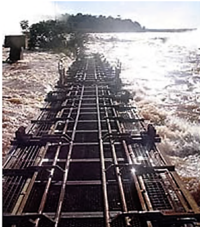
Tramos de pasarela caídos junto a su posición original y pila de apoyo sin daños
