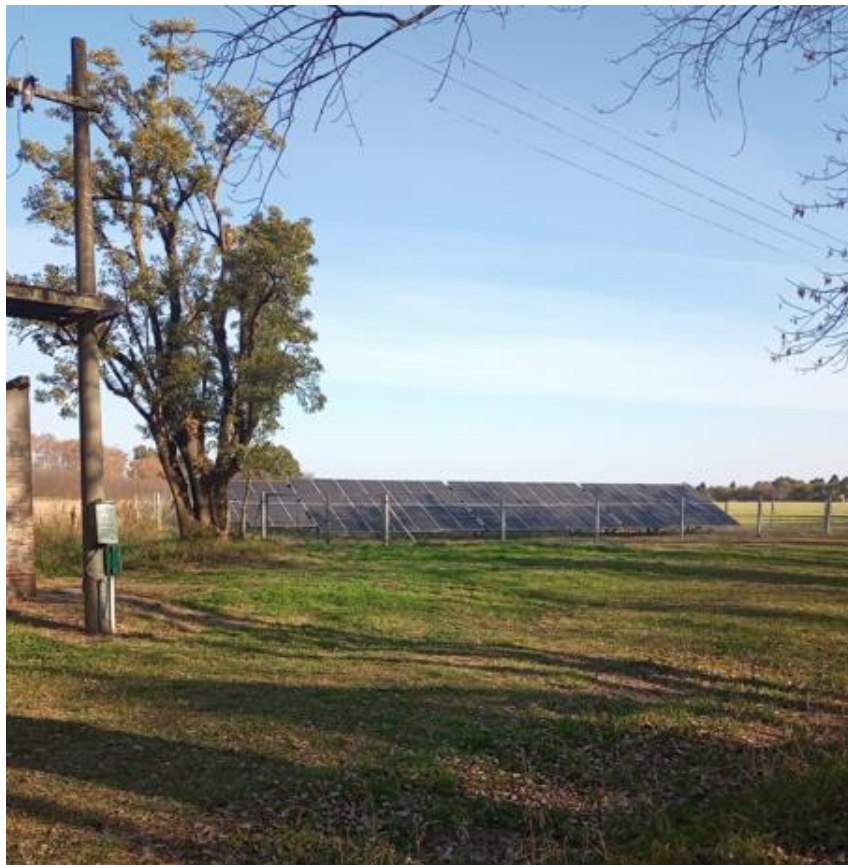
Imagen 30: Planta fotovoltaica en La Mariápolis
