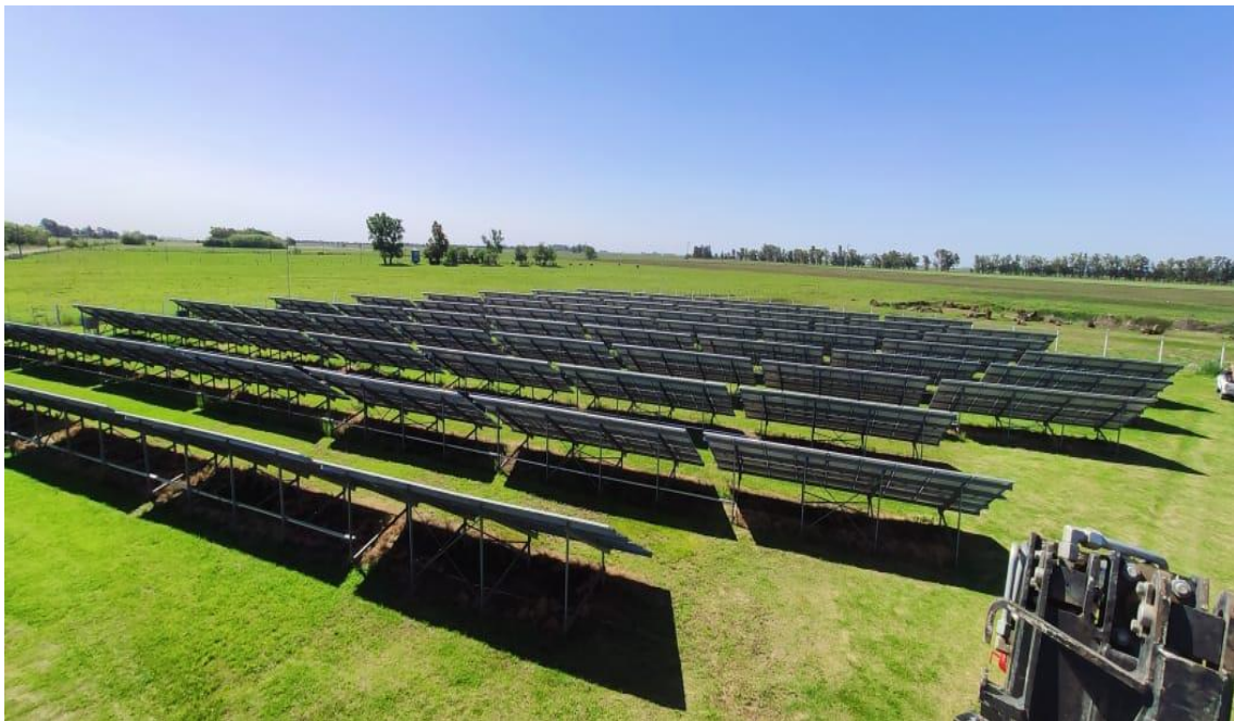
Imagen 7: Parque fotovoltaico Bayauca. Fuente: cooperativa eléctrica de Bayauca.
