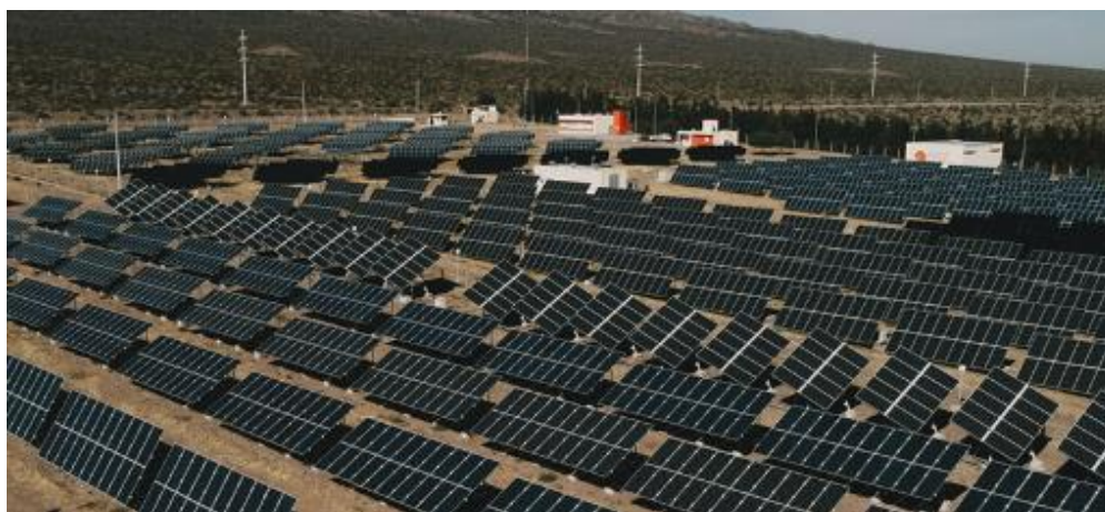
Imagen 6: Planta Solar San Juan I. Fuente: EPSE.
