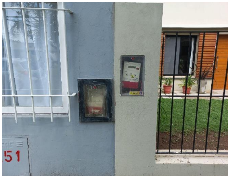
Imagen 17: Medidor inteligente en vivienda, Trenque Lauquen.
