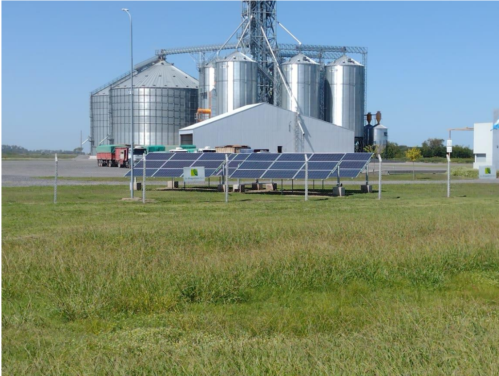
Imagen 20: Instalación fotovoltaica en La Bragadense, sede Chivilcoy.
