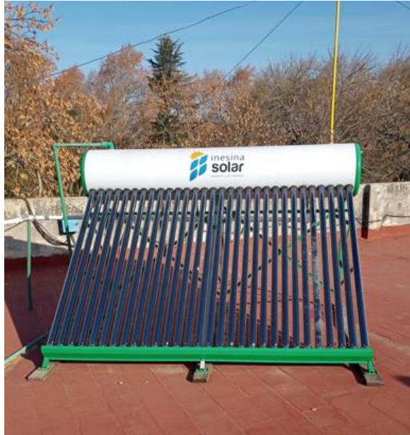
Imagen 31: Colector solar sobre el techo de la capilla, La Mariápolis.
