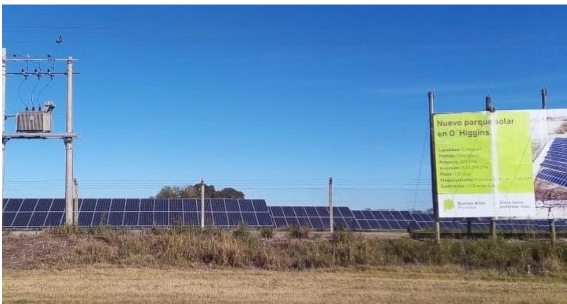
Imagen 27: Planta fotovoltaica de O'Higgins.
