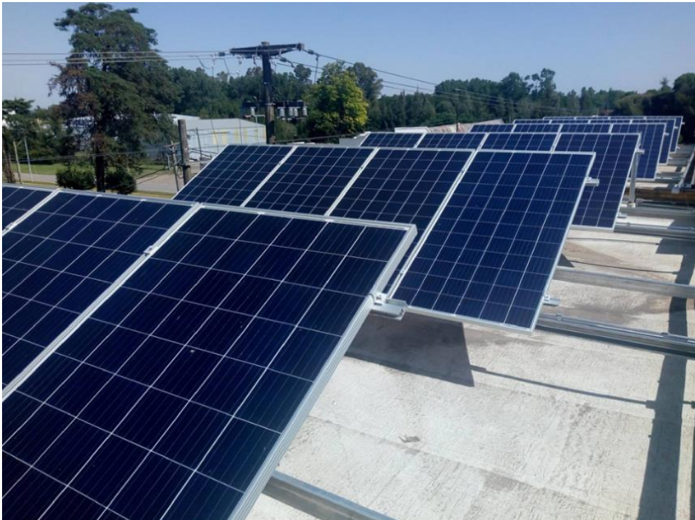
Imagen 19: Instalación fotovoltaica en La Bragadense, sede Bragado. Fuente: FIASA
