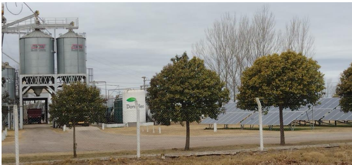
Imagen 21: Instalación fotovoltaica en Don Óleo, Chazón
