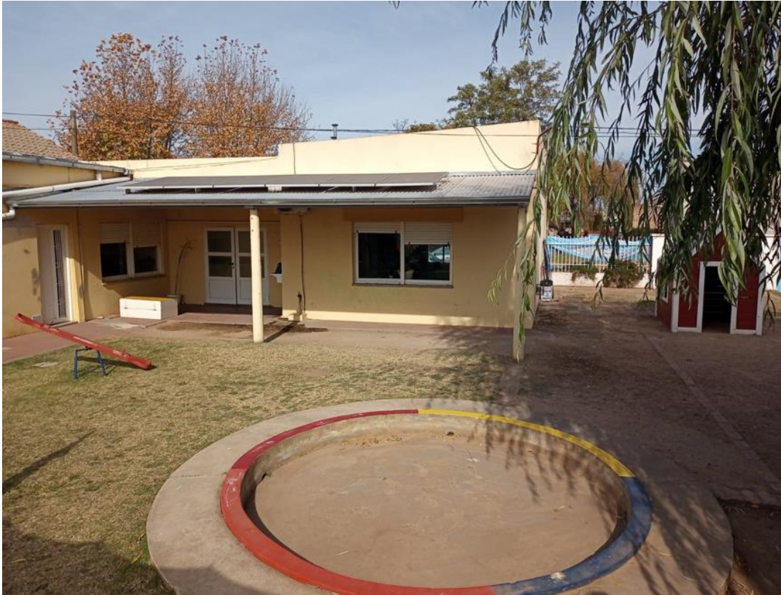
Imagen 29: Instalación fotovoltaica en Jardín de Infantes N.902, O'Higgins.
