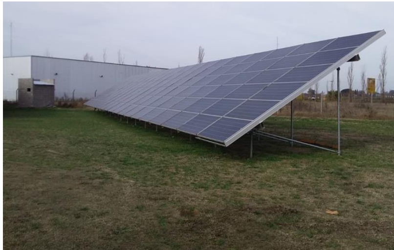
Imagen 22: instalación fotovoltaica en planta de MEGA, Lincoln.
