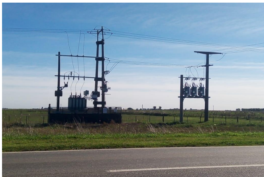
Imagen 9: Transformador de Bayauca, sobre ruta 188.
