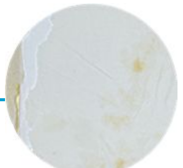
Dobles y desprendimientos
