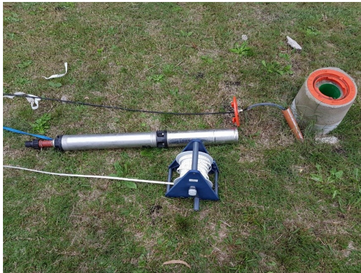
Figura 2.11. Bomba Grundfos, sonda manual utilizada para monitorear los descensos y brocal del pozo de bombeo.
