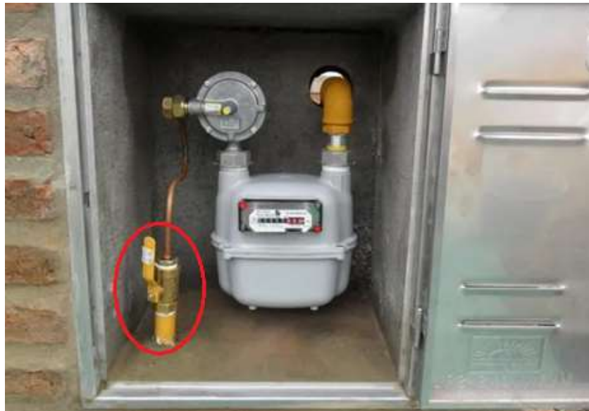
Figura 14 - Nicho de Gas de cliente con válvula de corte
