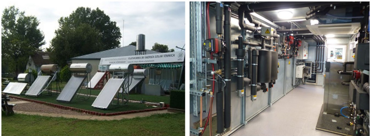
Figura 3: Plataforma Solar Térmica de INTI y sala de mediciones.
