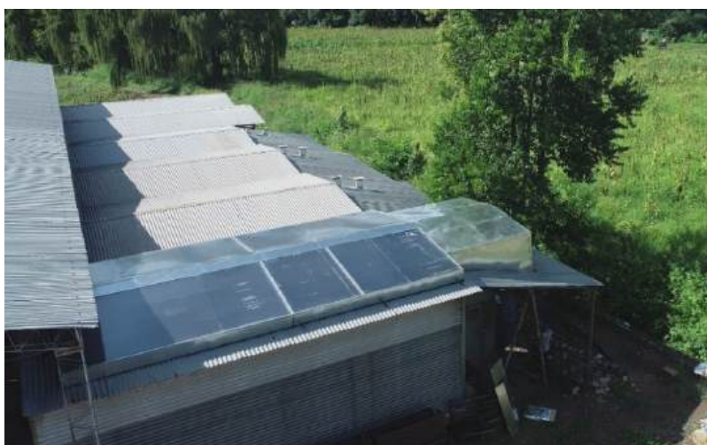
Figura 6: Fotografía aérea del sistema propuesto ya instalado en los techos de la estufa. Calentadores solares y envolvente a la unidad de calor.
