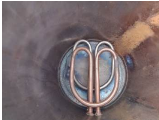
Figura 2: Sistema de calentamiento con resistencias de ACS
