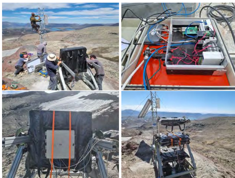
Figura 7.7: Fotos de la instalación del detector de muones, antena de comunicaciones, paneles solares y baterías en el sitio seleccionado.
