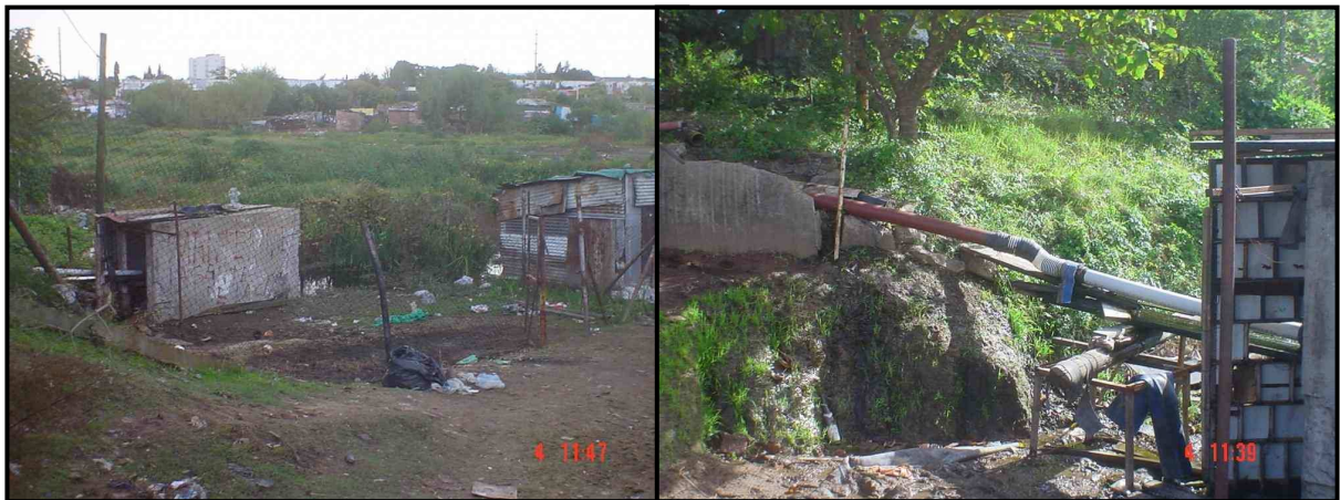
Foto 3.15: Estación de bombeo, año 2001
