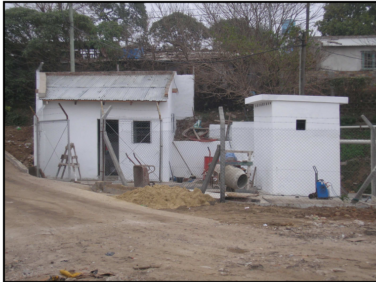
Foto 3.18: Estación de bombeo, año 2007
