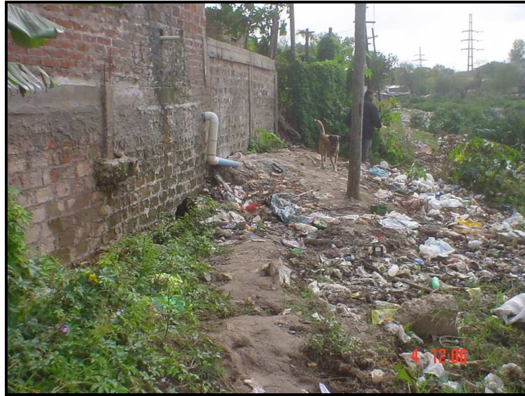
Foto 3.10: Parte posterior de una casa construida sobre el talud. El caño de PVC cloacal (blanco DN110) descarga en un pozo negro ubicado en la parte más baja
