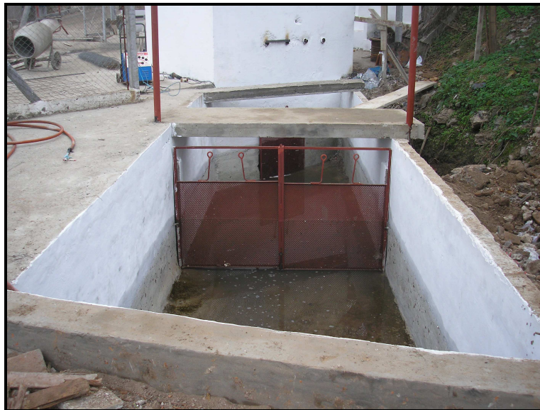
Foto 3.19: Reja de protección acceso a cámara. Estación de bombeo, año 2007
