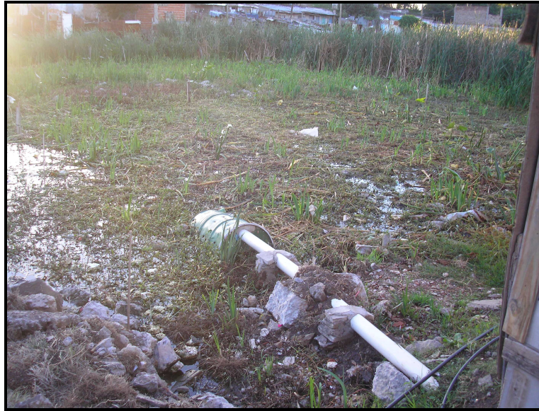
Foto 3.12: Vista de una descarga cloacal directa a la laguna
