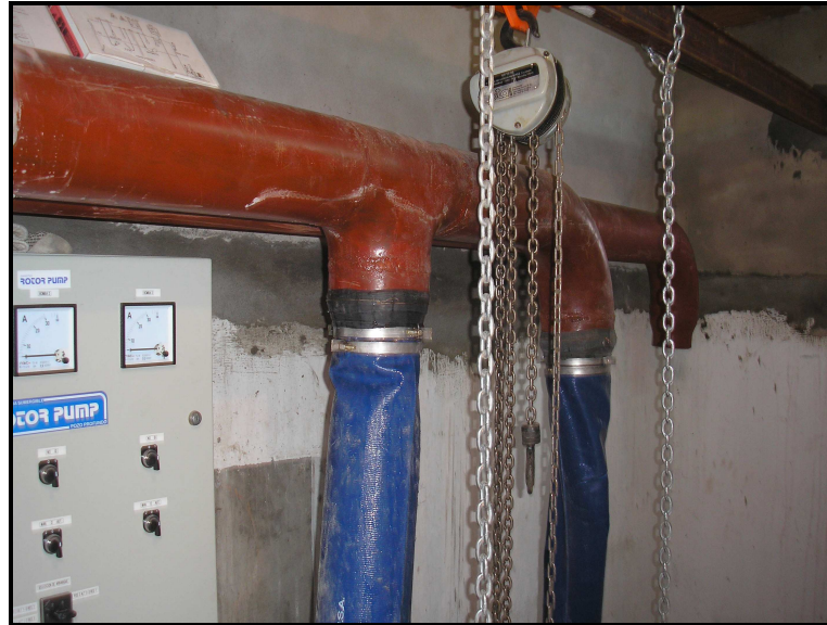
Foto 3.20: Tablero eléctrico, sistema de izaje de electrobombas, Estación de bombeo, año 2007
