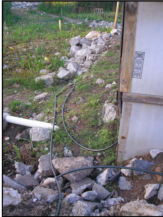
Foto 3.6: Vista de las conexiones a la red de agua potable
