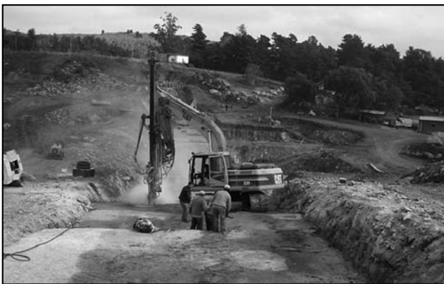
Figura 11. Sobre la superficie del hormigón de regularización se observa el equipo de perforación de los taladros de inyección sobre el lateral derecho de la fundación de la presa y personal colocando el sistema de obturación para la inyección de un tramo en un taladro de consolidación.
