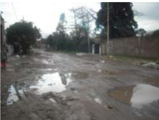
Calle Centenera Barrio Parque Peluffo-2012 Foto del autor
