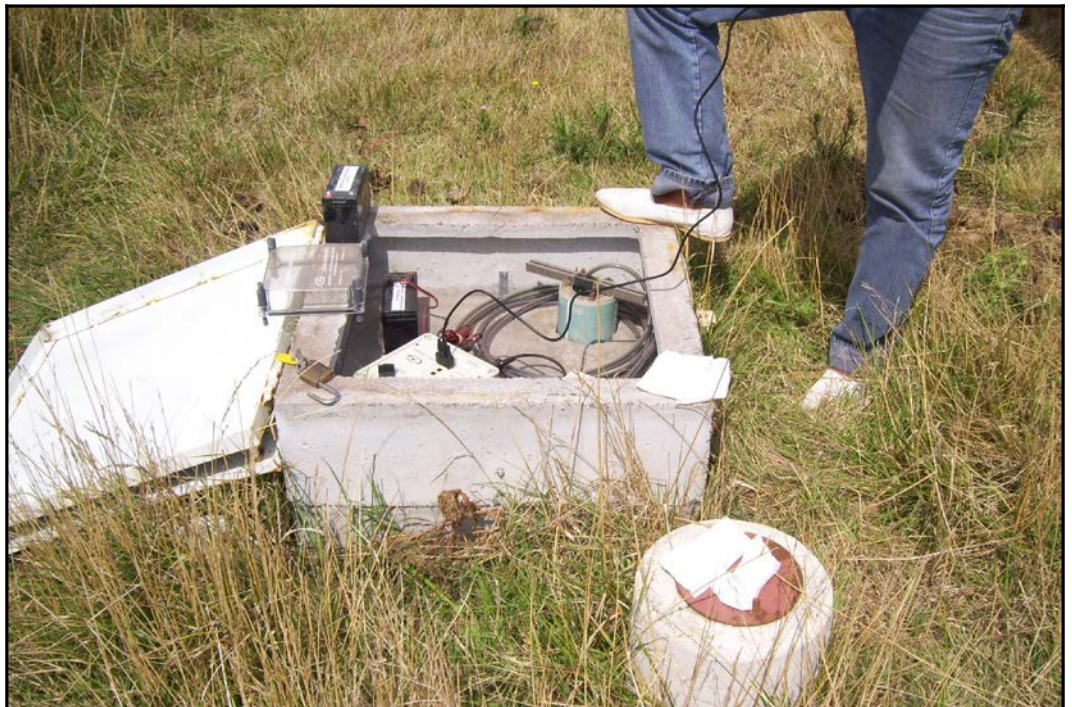
Foto 7.13: Pozo somero con limnógrafo en su cámara junto a perforación de 30 m.
