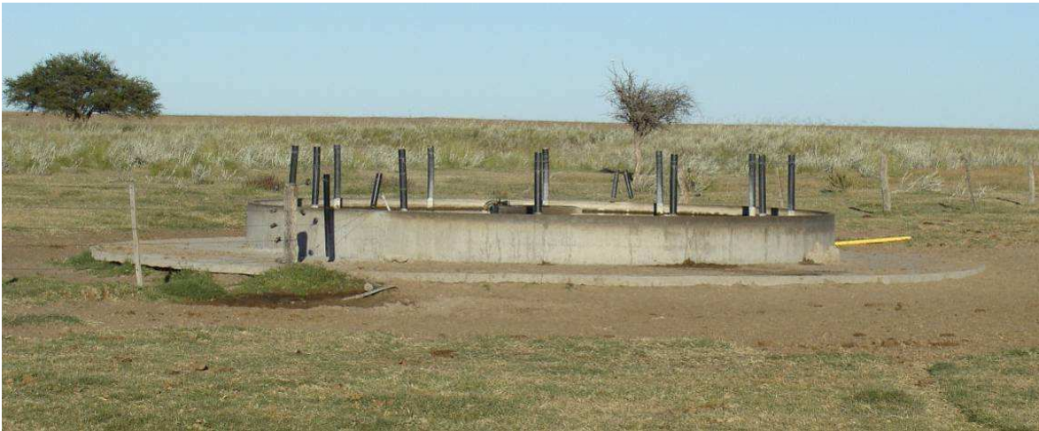
Fig. III. 7. Aguada circular de hormigón, presente en la estancia “El Centenario”.
