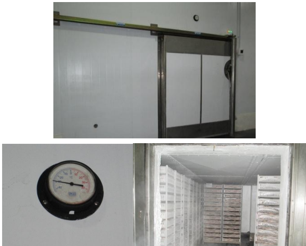
Fig. 3.2- Túnel de congelación
