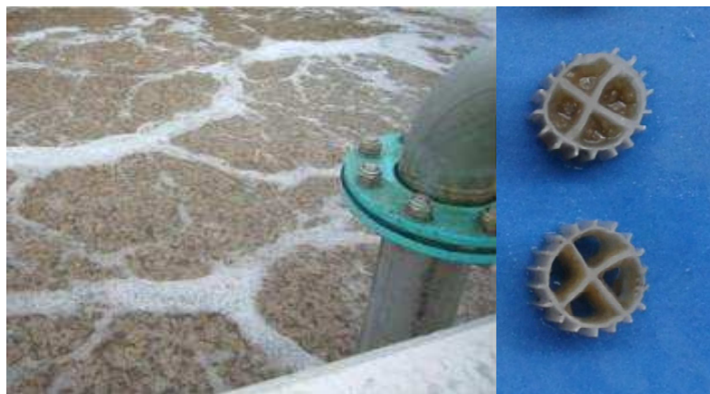
Figura 1.10 Planta de tratamiento con soportes K1 (izquierda), biomasa adherida sobre soportes K1 (derecha).
