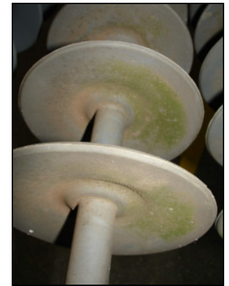
Foto 8. Aislador proveniente de zona de alta humedad
