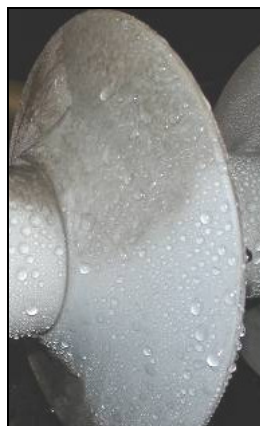
Foto 12. Aislador contaminado con hollín y limpiado (grupo 4)
