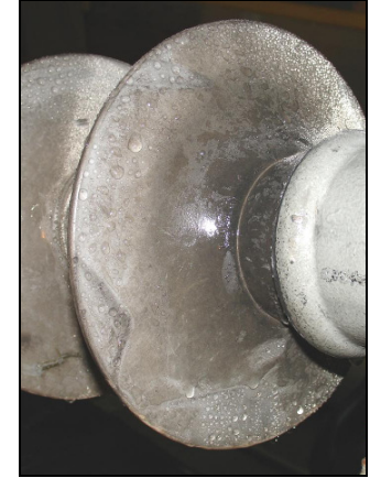
Foto 11. Hollín. Distribución en la parte superior y central de las aletas
