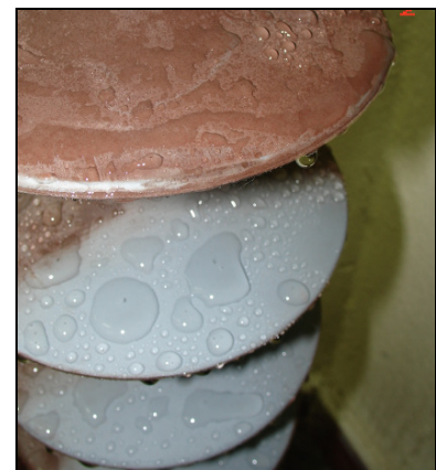
Foto 13. Aislador contaminado con hierro, sílice y cal y limpiado (grupo 3)
