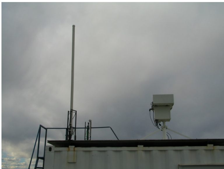
Figura 2-4 Antena instalada en Rio Gallegos
