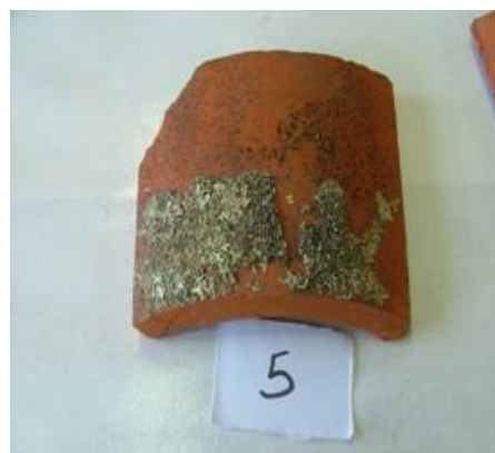
Fotografía 8: Teja de 60 años luego del crioarenado a 2.5 bar Se observa la pérdida de material superficial.
