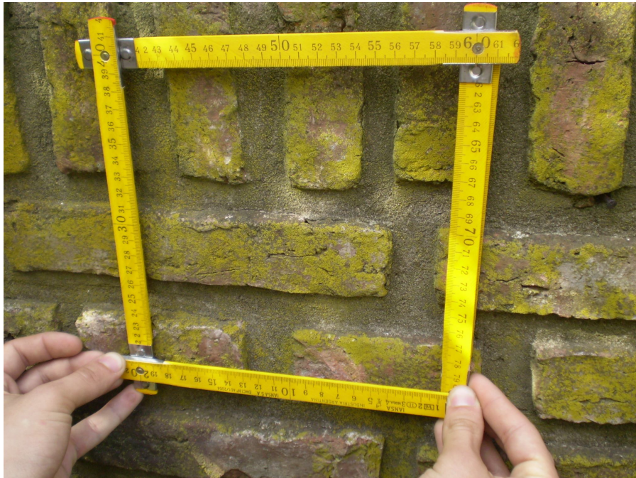
Fotografía 4. Toma de muestras. Se observa la gran cobertura de Calopalca austroclitina en ese sector del muro.
