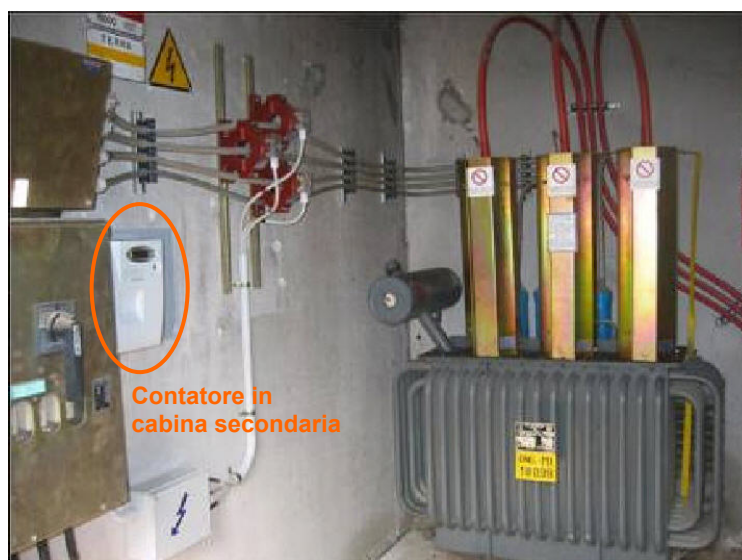
Figura 39. Contatore installato in cabina secondaria.
