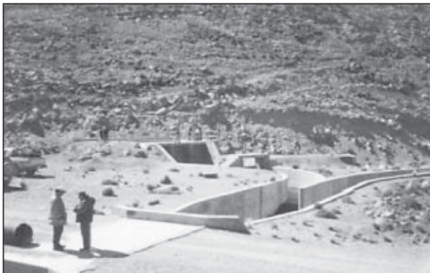
Figura 3 Compuertas o bocatoma de Kovire
