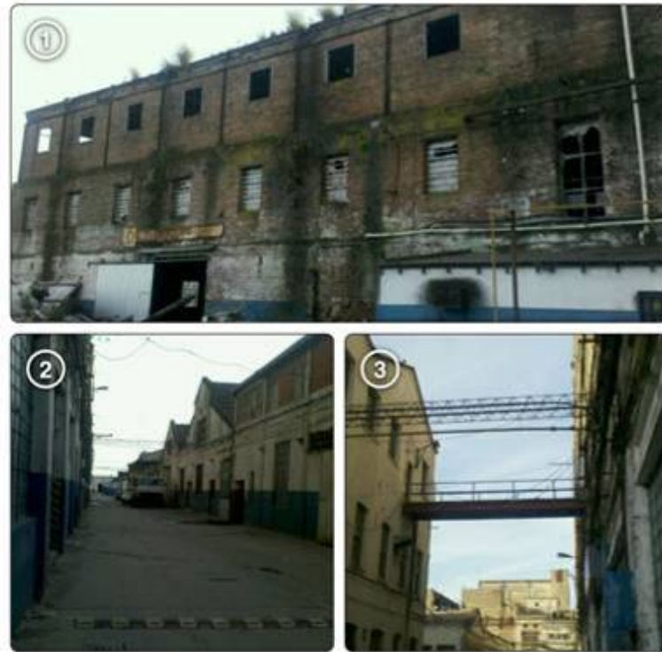
Figura 11. Imágenes que representan los espacios (pos) industriales del polígono industrial ex frigorífico Swift (Berisso). Se observa en la infraestructura, la impronta del pasado industrial, como también el abandono y el desuso. Pero perdura su gran estructura albergando diferentes empresas privadas.
