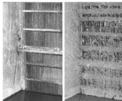
Rejas de protección en el sistema de captación de agua de río para refrigeración de la Central Nuclear Atucha I; limpias (izquierda), y pobladas por el molusco Limnoperna fortunei algunos meses después de haber sido limpiadas mecánicamente (derecha) (gentileza del Ing. Pablo Zanni).
