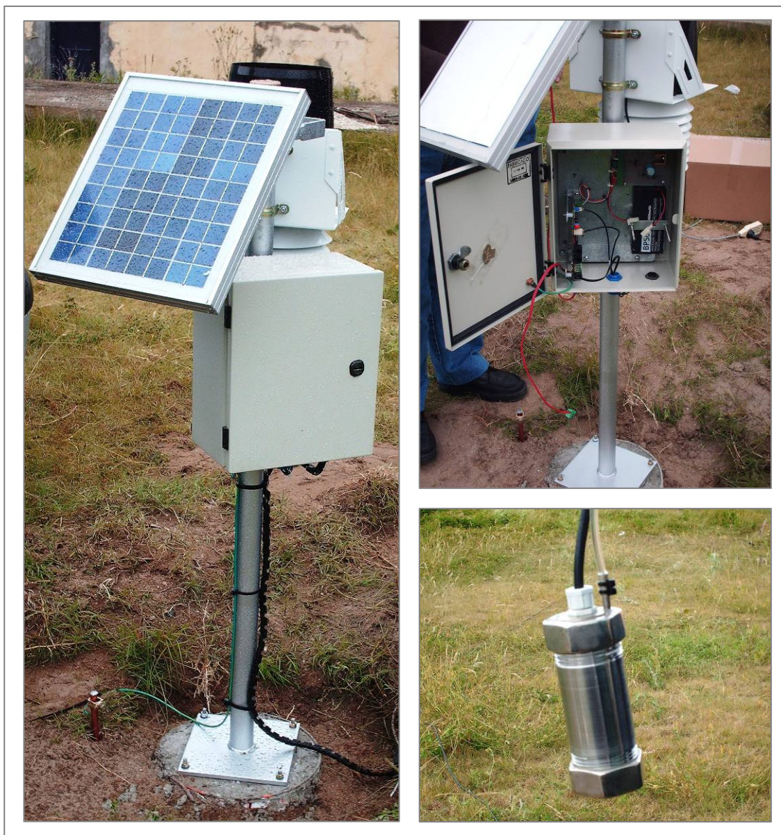
Figura 2.7. Estación meteorológica Planta 2. Detalle del sensor de medición de la columna de agua.
