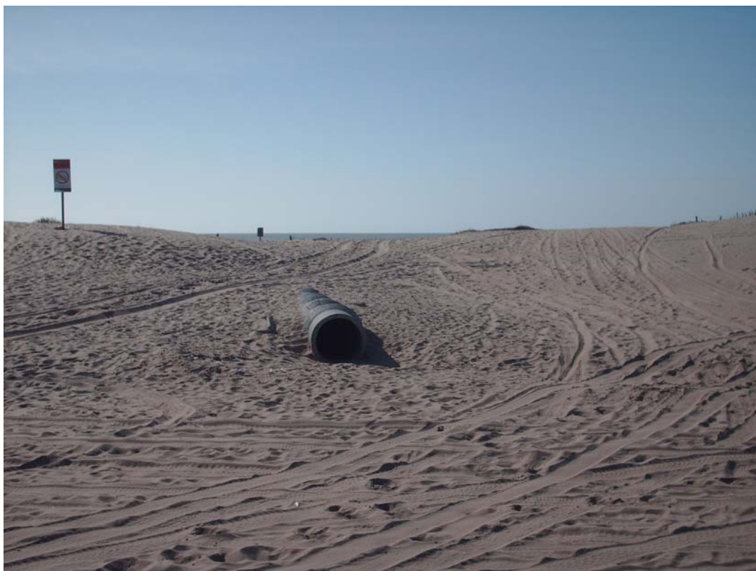
Figura 6.8. Caños pluviales colocados en la Av. Costanera que descargan hacia la playa y el mar
